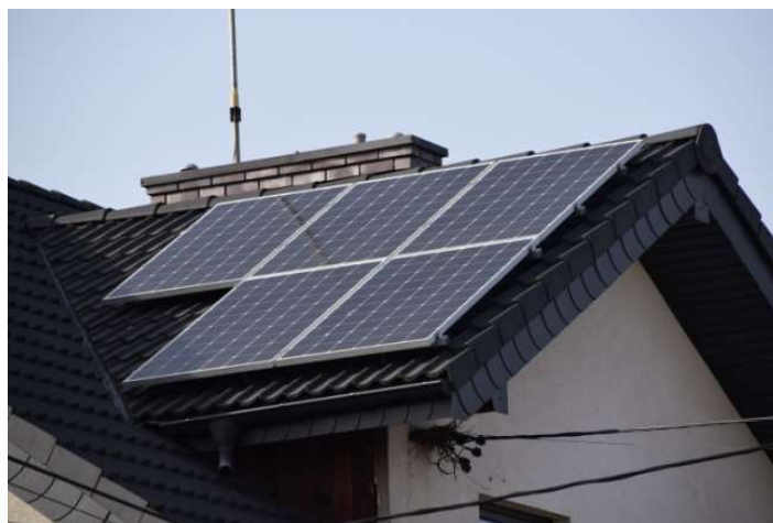
Instalacja fotowoltaiczna na dachu budynku mieszkalnego.
