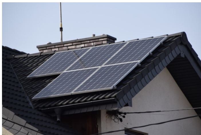
Instalacja fotowoltaiczna na dachu budynku mieszkalnego.
