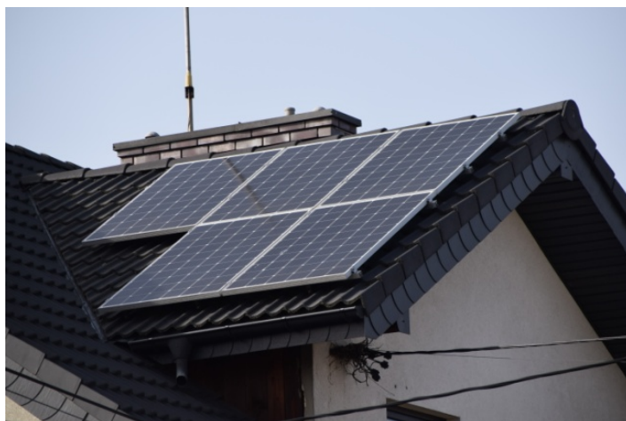
Instalacja fotowoltaiczna na dachu budynku mieszkalnego.
