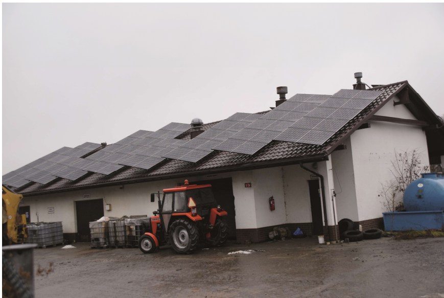
Instalacja fotowoltaiczna na budynku Zakładu Usług Wodnych i Kanalizacyjnych w Siewierzu.
