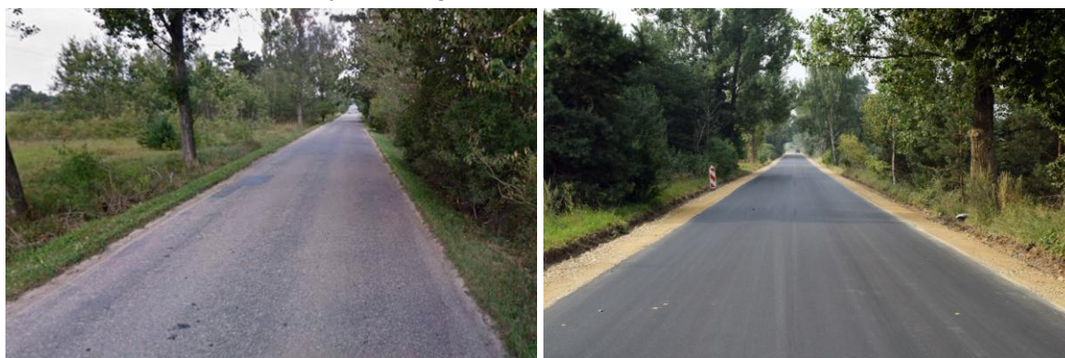
Stan drogi w Nowej Wiosce przed remontem.
