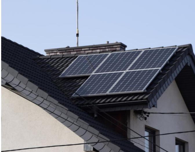
Ogniwa fotowoltaiczne zamontowane na budynku.
